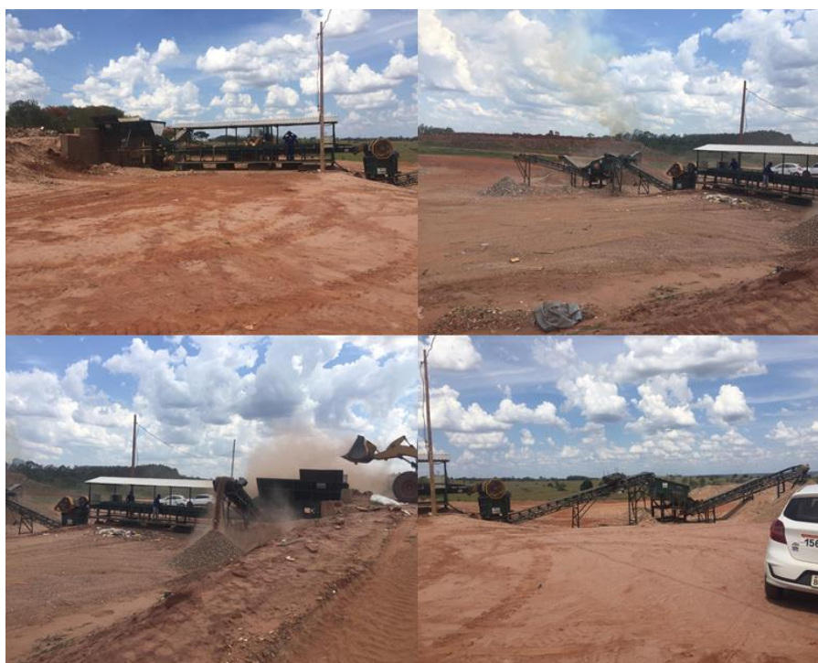
Figura 28 - Registro fotográfico da Usina de Reciclagem de RCC em Umuarama-PR. Fonte: Equipe Técnica (2019)
