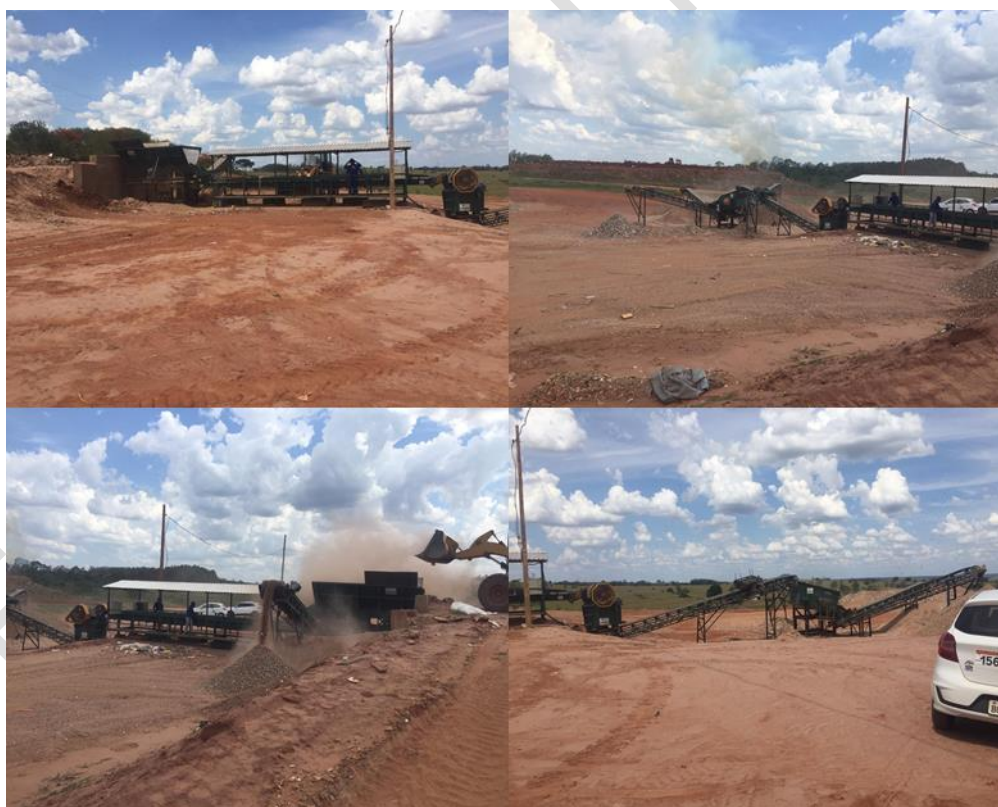
Figura 21 - Registro fotográfico da Usina de Reciclagem de RCC em Umuarama-PR. Fonte: Equipe Técnica (2019)
