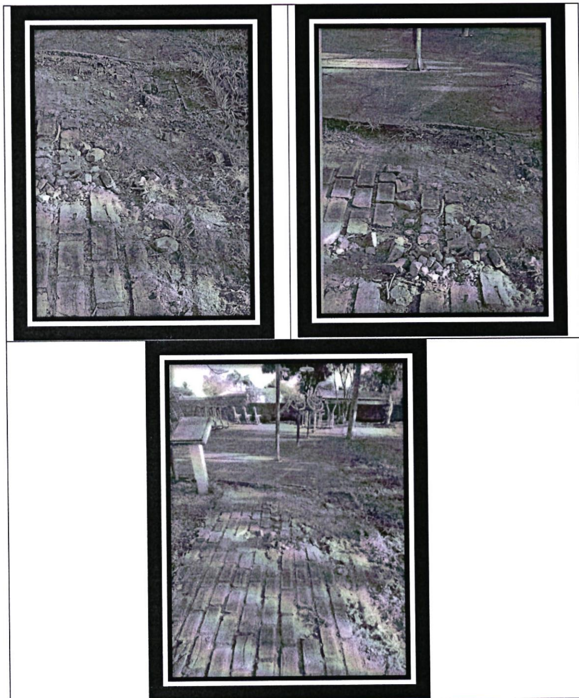
FOTOS – SITUAÇÃO QUE SE ENCONTRA A CALÇADA
